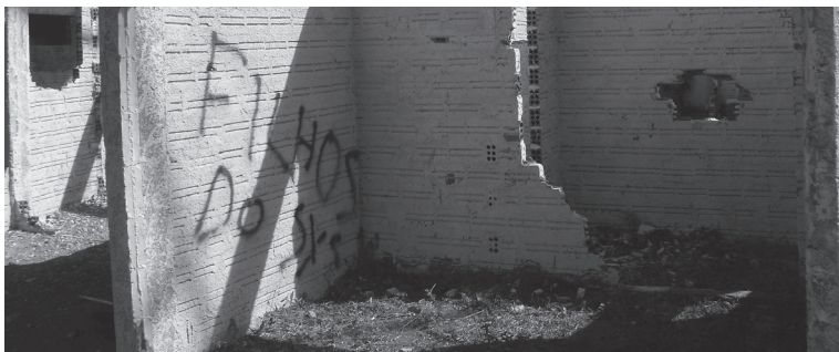
Anfiteatro obras interrompidas e vítimas de vandalismo, gestão da municipalidade
