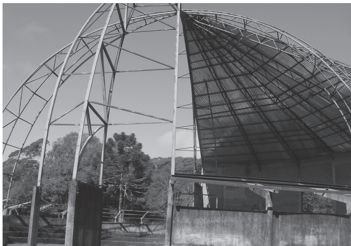
Anfiteatro obras interrompidas e vítimas de vandalismo, gestão da municipalidade
